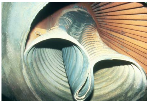
Rysunek 1. Uszkodzenie płomienicy kotła na skutek braku wody
