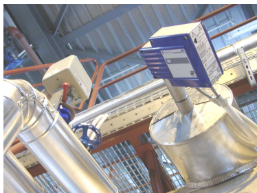
Rys.2 Układ automatycznego odsalania GESTRA na nowym kotle
