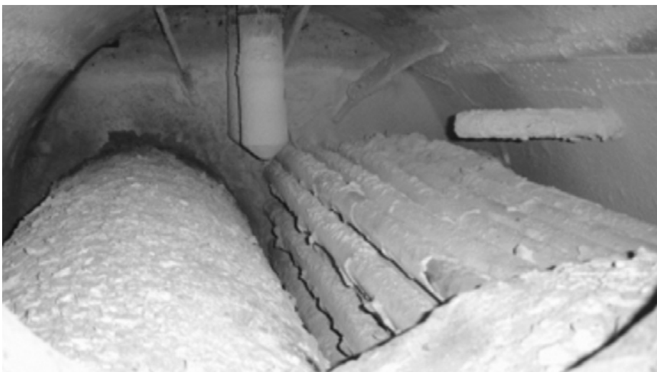
Fig. 1 Auf den Heizflächen dieses Dampferzeugers bildete sich starker Belag infolge schlechter Wasserqualität. Zunächst brachte die wachsende Stärke des Belags einen hohen Energieverlust, später führte der Wärmestau an den Heizflächen zu einer Einbeulung der Wendekammer. Dieses Schadensbild birgt eine erhebliche Gefahr für Mensch und Anlage.
